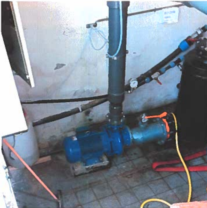
De nieuwe zwembadpomp (4 kW)
